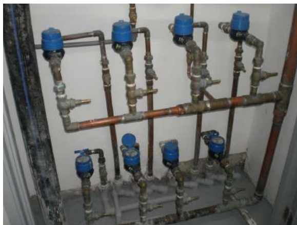
Medidores Agua Fría y Llaves de paso
