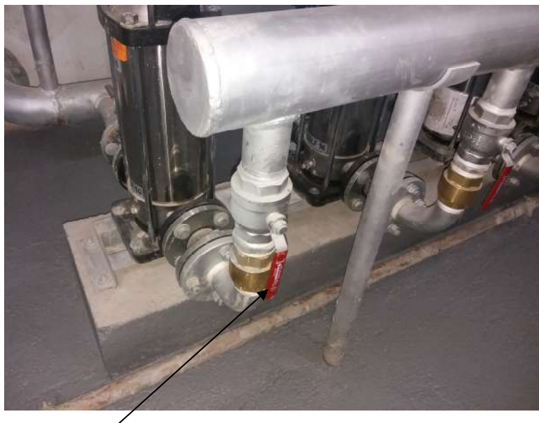
Válvula de corte en sala de bombas
